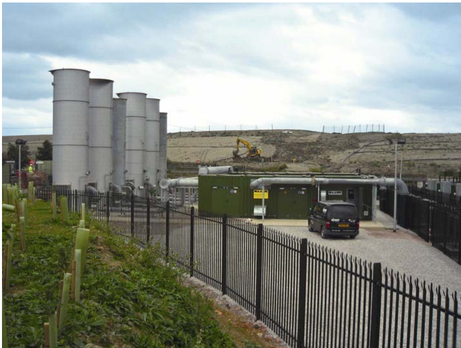
Bild 3 : 6 Deponiegasfackeln auf der Deponie Brogborough, England Gesamtfeuerungsleistung 60 MW. Die dazugehörige HAASE Gasverdichterstation fördert 13.800 m 3 /h Deponiegas
